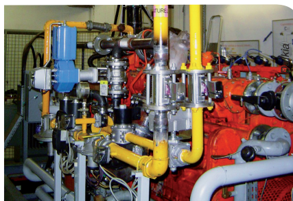
Moteur de cogénération de l'école des Mines
